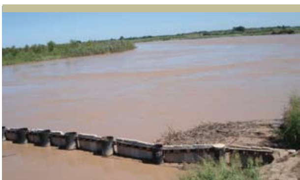
Figura 3.56 Espigón de pilotes con placas, crecida, margen izquierda río Bermejo en El Colorado, 2006
