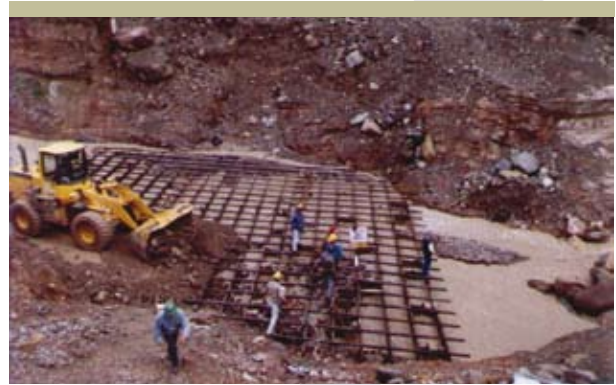
Figura 2.35 Río San Andrés, protección del lecho contra la acción de flujos de barro en correspondencia con cruce de gasoducto, 2001
