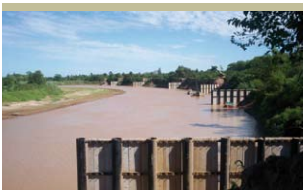
Figura 3.55 Espigón de pilotes con placas margen izquierda río Bermejo en El Colorado, 2006
