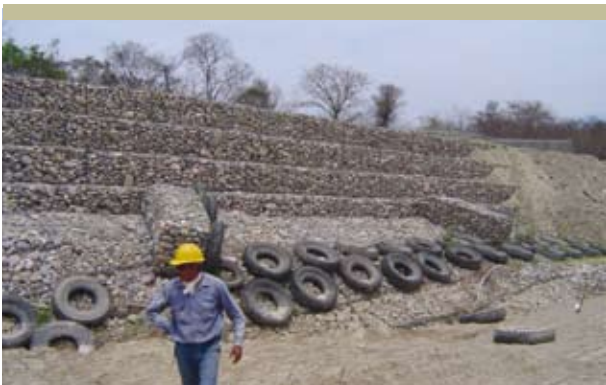
Figura 2.33 Río Pescado, muro longitudinal con cubierta de neumáticos, 2006
