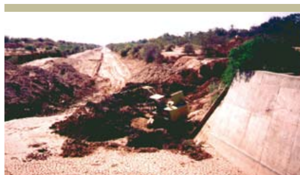
Figura 3.59 Sedimentación pre-toma Laguna Yema, provincia de Formosa
